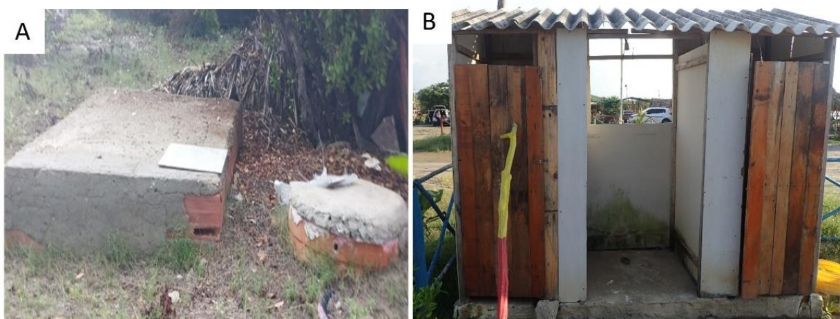
Figura 5-27. Pozas sépticas en el sector de la playa de Puerto Veleró (A) y baño con su poza séptica en el sector de Caño Dulce (B). Fotos: Cristian Ruiz.
